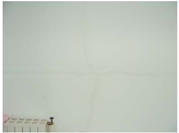
위 치 관리동 내부 벽체 내 용 조적균열
