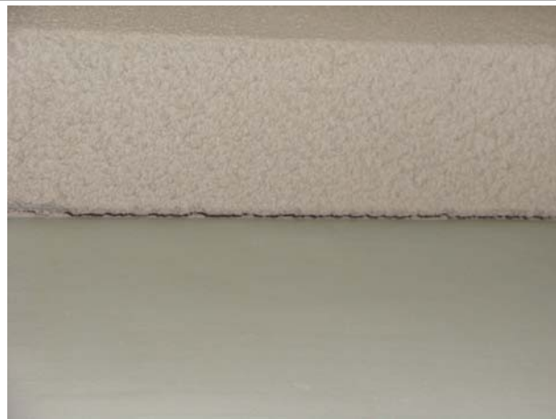
위 치 관리동 1층 내부 전기실 내 용 상부슬래브 이격
