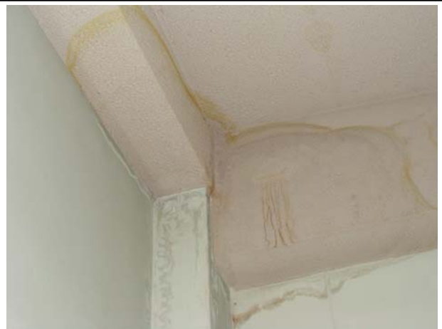
위 치 관리동 1층 내부 전기실 내 용 상부슬래브 누수흔적
