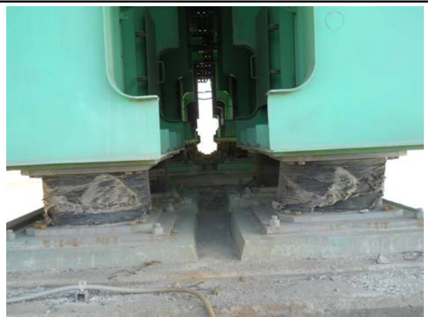
위 치 STEEL BOX(S25-원주방향 G1) 내 용 플레이트 부식
