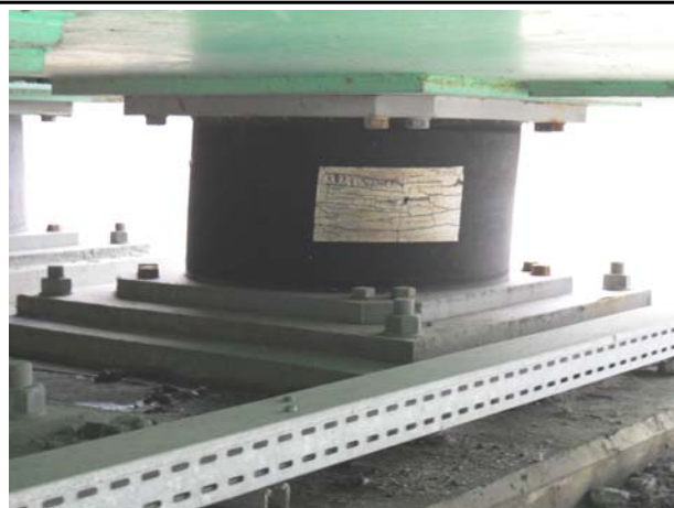
위 치 STEEL BOX(S18-원주방향 G1) 내 용 플레이트 부식
