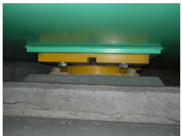
위 치 1경간 A1(원주방향) 내 용 BR2 교좌장치 상태
