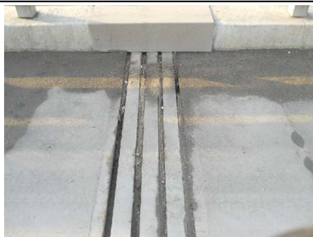
위 치 신축이음부(원주방향 - P25) 내 용 유간 토사퇴적(원주방향 - P25)
