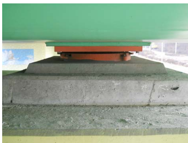
위 치 P1(원주방향) 내 용 BR2 교좌장치 상태
