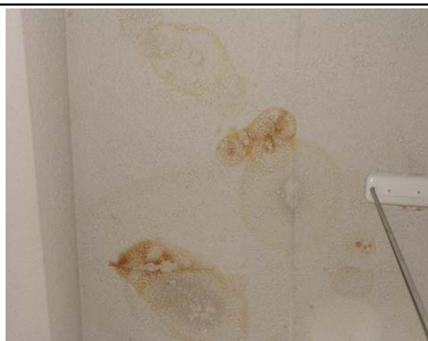
위 치 관리동 1층 내부 전기실 내 용 상부슬래브 누수흔적
