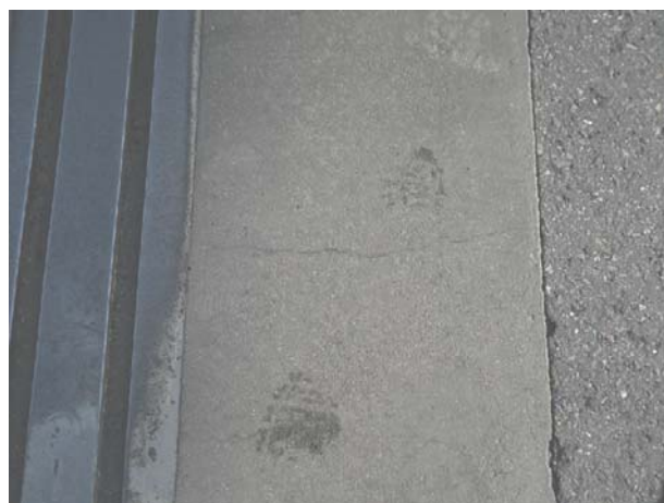
위 치 신축이음부(원주방향- A1) 내 용 후타재 균열
