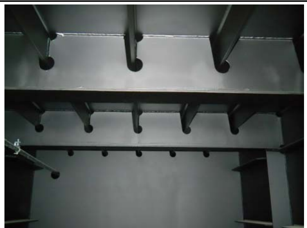
위 치 1경간 G3(양평방향) 내 용 종 리브 상태
