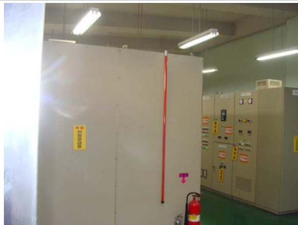
위 치 관리동 1층 전기실 내 용 내부 전경
