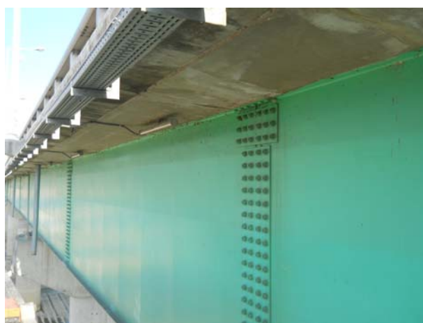
위 치 슬래브하면(S15) 내 용 슬래브하면 캔틸레버부 외측 상태
