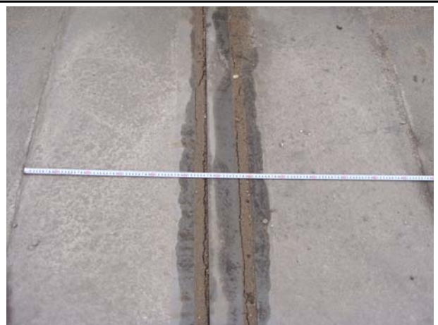
위 치 신축이음부(양평방향 A2 - 111mm) 내 용 유간측정 장면
