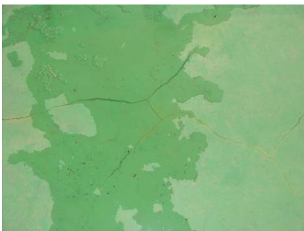
위 치 관리동 옥탑 내 용 바닥슬래브 망상균열
