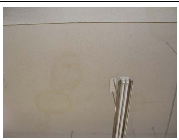
위 치 관리동 1층 내부 기계실 내 용 상부슬래브 누수흔적
