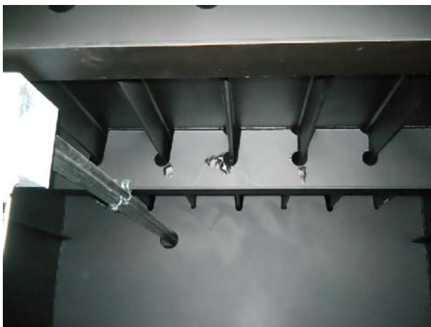
위 치 STEEL BOX(S27-양평방향 G1) 내 용 STEEL BOX 내부 도장박리
