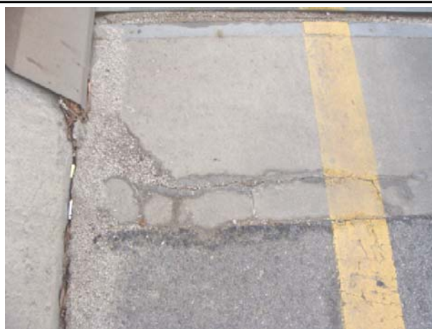
위 치 신축이음부(양평방향 - P4) 내 용 후타재 파손
