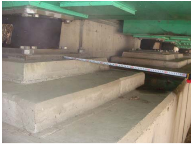
위 치 교좌장치(A1-원주방향 G2) 내 용 교좌장치 상태
