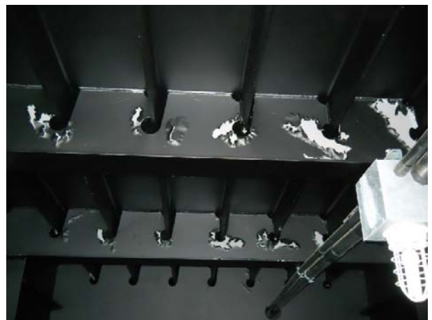
위 치 STEEL BOX(양평방향 - S27 - G2) 내 용 STEEL BOX 내부 도장박리
