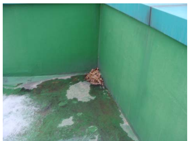
위 치 관리동 2층 외부 내 용 배수구 막힘
