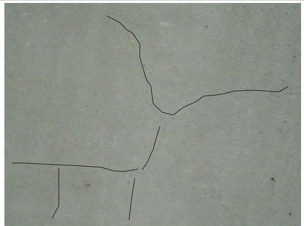
위 치 3경간 슬래브 하면(양평방향) 내 용 균열 발생 상태
