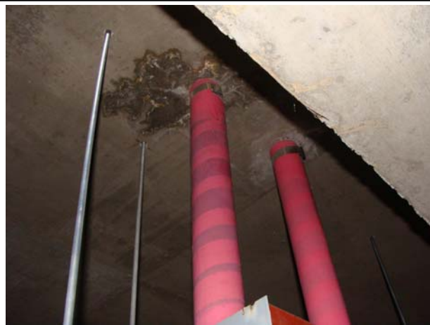
위 치 관리동 1층 내부 상황실 내 용 상부슬래브 누수흔적
