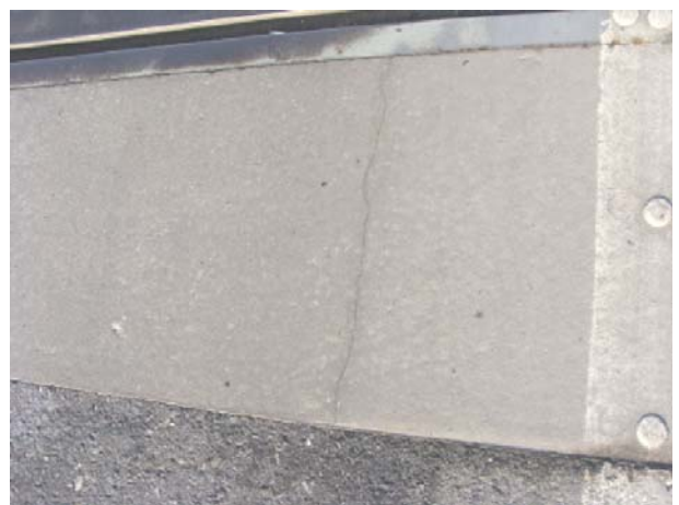
위 치 신축이음부(양평방향 - P18) 내 용 후타재 균열
