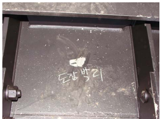
G2(원주방향) 도장박리 발생 상태
