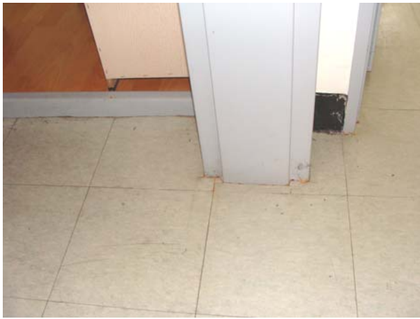
위 치 관리동 2층 내부 숙직실 내 용 바닥 슬래브 누수흔적
