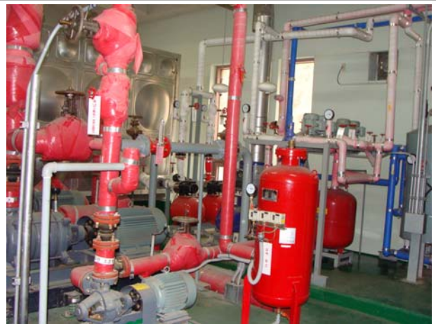
위 치 관리동 1층 기계실 내 용 내부 전경
